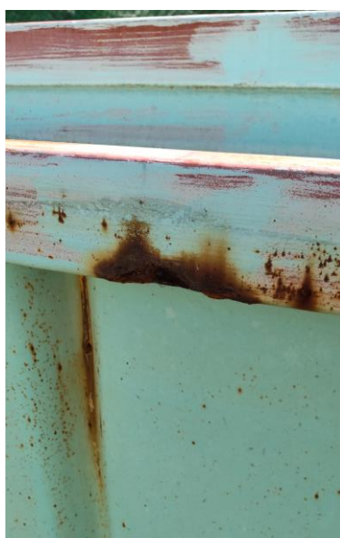
写真4 側面の腐食②
