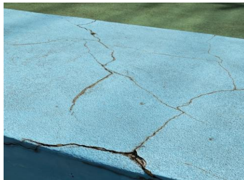
写真2 飛び込み台の亀裂
