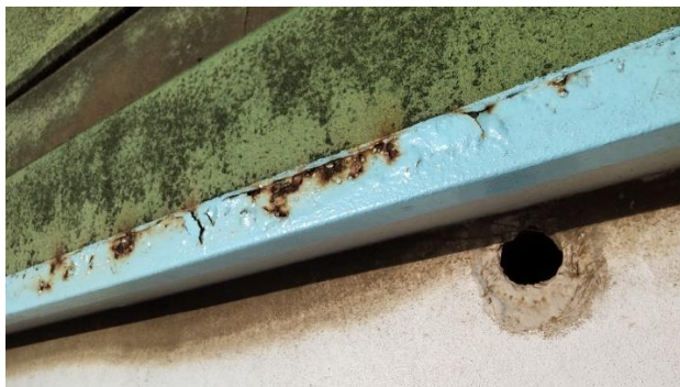
写真1 プールサイドの腐食
