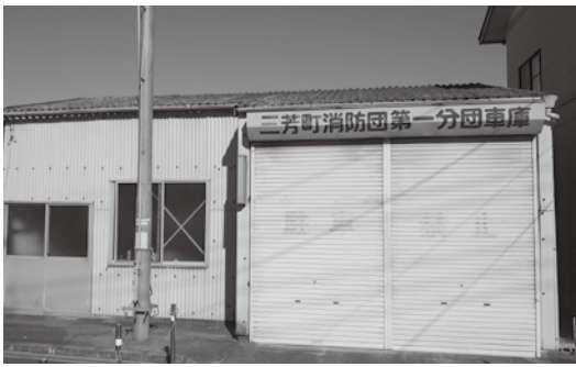
老朽化が進む消防団車庫（昭和59年築）
